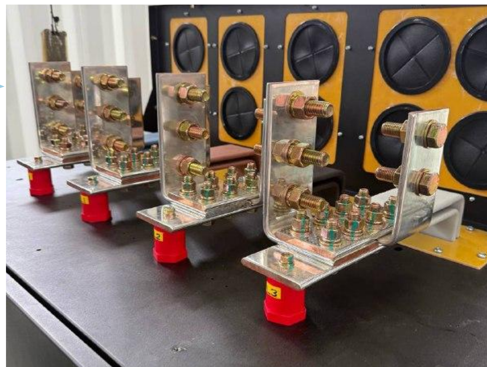
point d'alimentation électrique central
